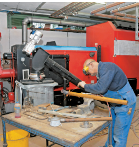
Bis zum Start des Kombiheizwerkes hatten die Mitarbeiter der ausführenden Heizungsbaunternehmen alle Hände voll zu tun
