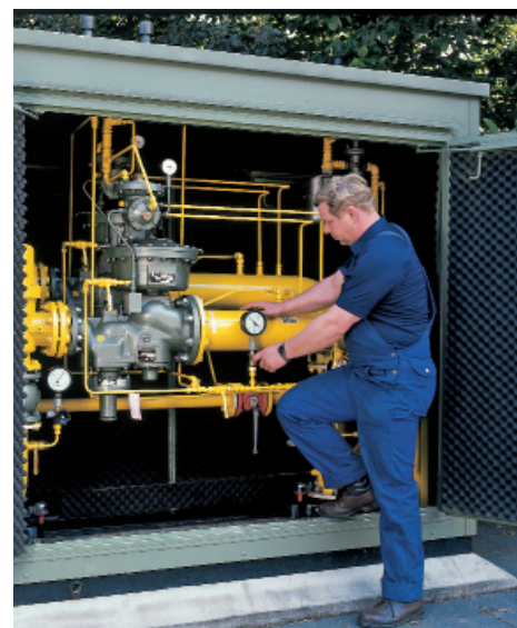
Ein Mitarbeiter der BEW überprüft den Gasdruck in einer Verteilstation
