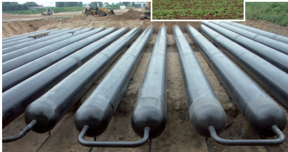
Der Röhrenspeicher an der Pannemannstraße kann bis zu 345.000 Kubikmeter Erdgas speichern
