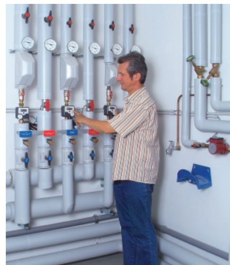
Moderne Wärmeverteilung in einem Heizraum
