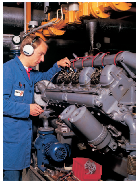
Die Verbrennungskraftmaschine des BHKW wird regelmäßig gewartet
