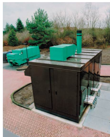
Hinter diesem „monolithischen Block“ verbarg sich die Brennstoffzelle des St.-Agnes-Hospitals
